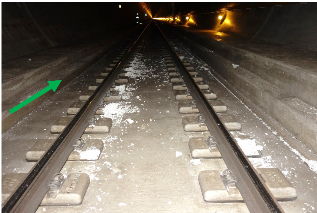
Figura 41: Traverse in cemento armato a destra e a sinistra del binario danneggiate dall'assile deragliato (km 46.7).
