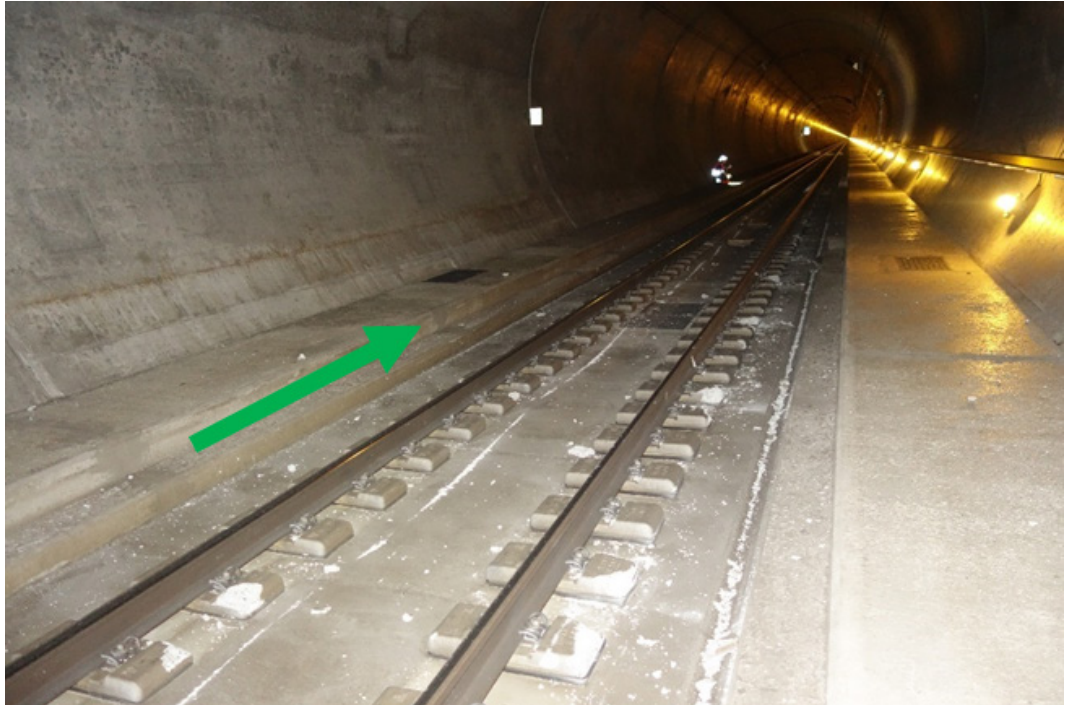
Figura 42: Segni di abrasione sul pavimento di cemento lasciati dal bordino della ruota sinistra dell'assile 1, carro 11. Danni su entrambi i lati delle traverse in cemento armato (km 46.60).
