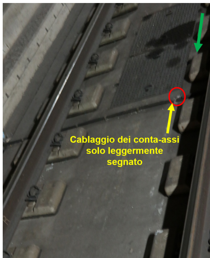
Figura 51: Involucro del cablaggio del conta-assi leggermente segnato, senza danni ai cavi (tratto 7705).
