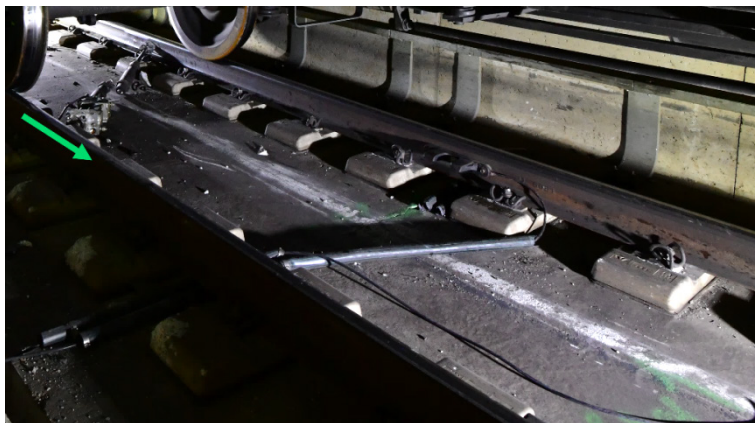
Figura 46: Ampi segni di abrasione sul pavimento in cemento tra gli scambi W387 e W386 causati dall'assile 1 deragliato del carro 11. Tra le traverse, il fermascambio divolto del deviatoio W387.
