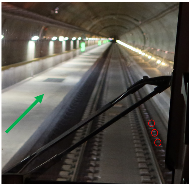
Figura 44: L'immagine ripresa dalla cabina di guida del treno di spegnimento e salvataggio (TSS) all'altezza del km 41.1 mostra i lievi danni tra il km 46 e 41, qui sul lato destro delle traverse in cemento armato (cerchi rossi).
