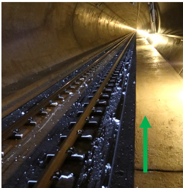
Figura 43: Segni di abrasione provocati dal bordino strisciante sul pavimento della galleria e frammenti delle traverse di cemento distrutte (ca. km 46.5).
