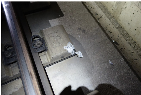
Figura 37: Danno alla traversa in cemento armato all'altezza del km 47.1 dovuto a un frammento di ruota staccatosi dall'assile 1 del carro 11.
