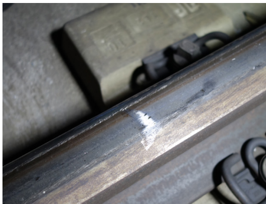
Figura 39: Segno sulla superficie di rotolamento della rotaia destra in direzione di marcia (km 46.9–46.8).
