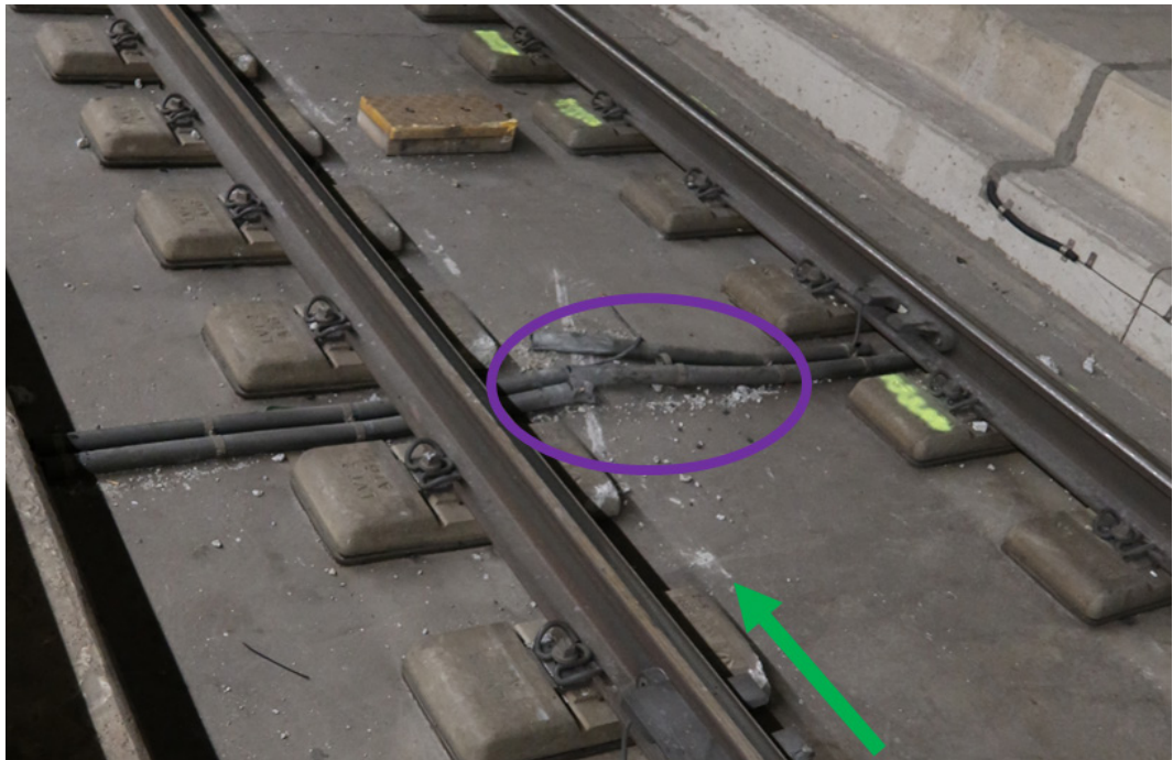
Figura 50: Cavi danneggiati del conta-assi del tratto 7707.
