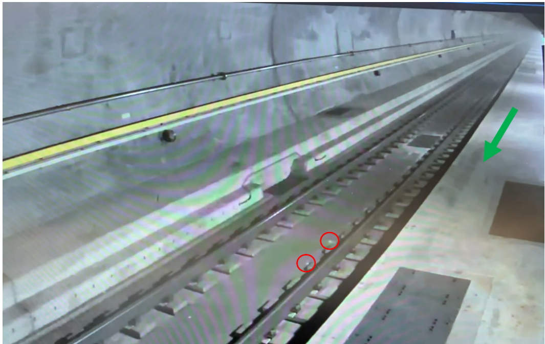
Figura 53: Stato dei binari dopo il passaggio del treno alla SMF di Faido (ca. km 40.8). I cerchi rossi indicano i segni lasciati sul pavimento di cemento. (Fonte: immagine della videosorveglianza della SMF di Faido di SBB).
