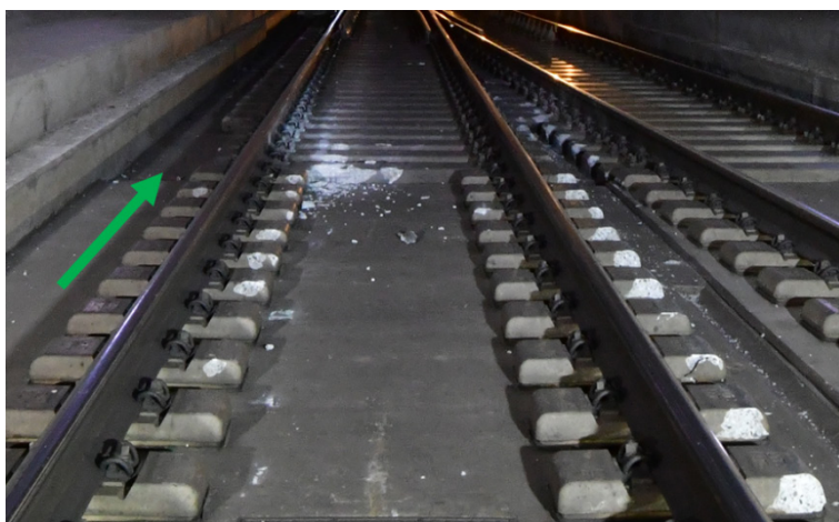
Figura 45: Evidenti segni dell'impatto sulla prima traversa monoblocco in cemento armato dello scambio W387.
